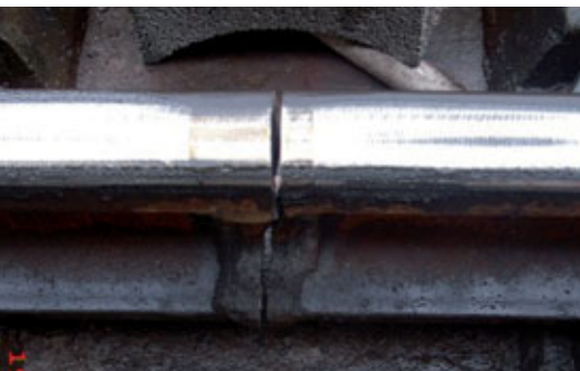
Bild unten links: Querbruchfläche mit hell glänzendem, kreisförmigen Rissausgangsbereich im Schweißgut zwischen Schienensteg und -fuß; Schweißung 1 und 3
